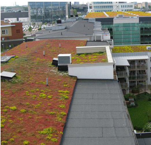
Exempel på gröna växtbeklädda tak, Västra hamnen i Malmö. (Foto: Veg Tech AB)
