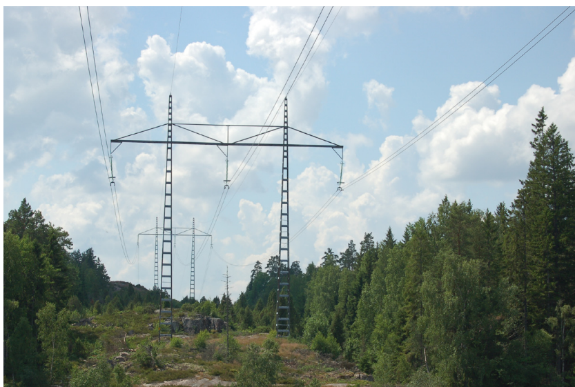
Ledningsgata väster om Sparresäter.
