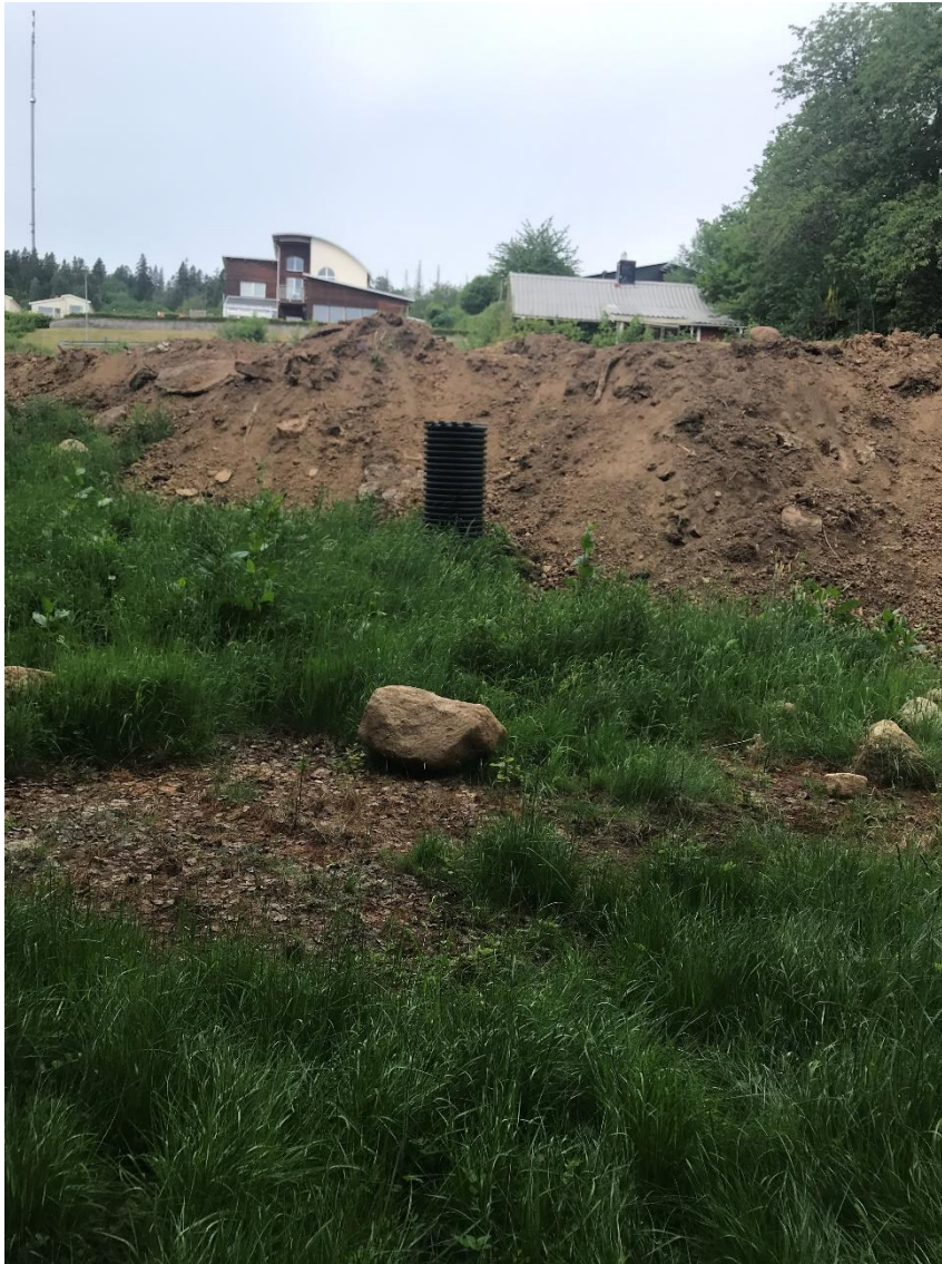
Figur 17. Bild 11. Vy åt nordväst, i bakgrunden syns villor som ligger väster om Lerdalavägen. Mitt i bild syns brunnen som står mitt på befintligt fastighet (Skövde 4:101). I brunnen bedöms vatten stå ca 0,5 m under marken. I förgrunden syns botten av sänkan som bildas av den gamla vägen. Vid besökstillfället känns marken fuktig men inte blöt.
