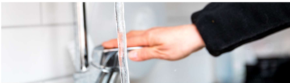
Figur 11. Vatten i kran
